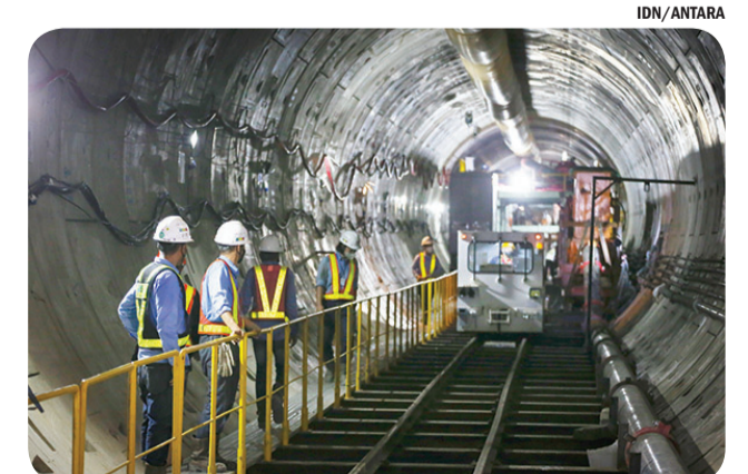
PROGRES PEMBANGUNAN JALUR MRT FASE 2A Pekerja menyelesaikan pembangunan jalur MRT Jakarta fase 2A CP201 di Jalan MH. Thamrin, Jakarta, Selasa (24/5). Direktur Utama PT MRT Jakarta (Persero) William Sabandar menyatakan pada 15 Mei 2022 progres pembangunan MRT Jakarta fase 2A CP201 sudah mencapai 38,80 persen.
